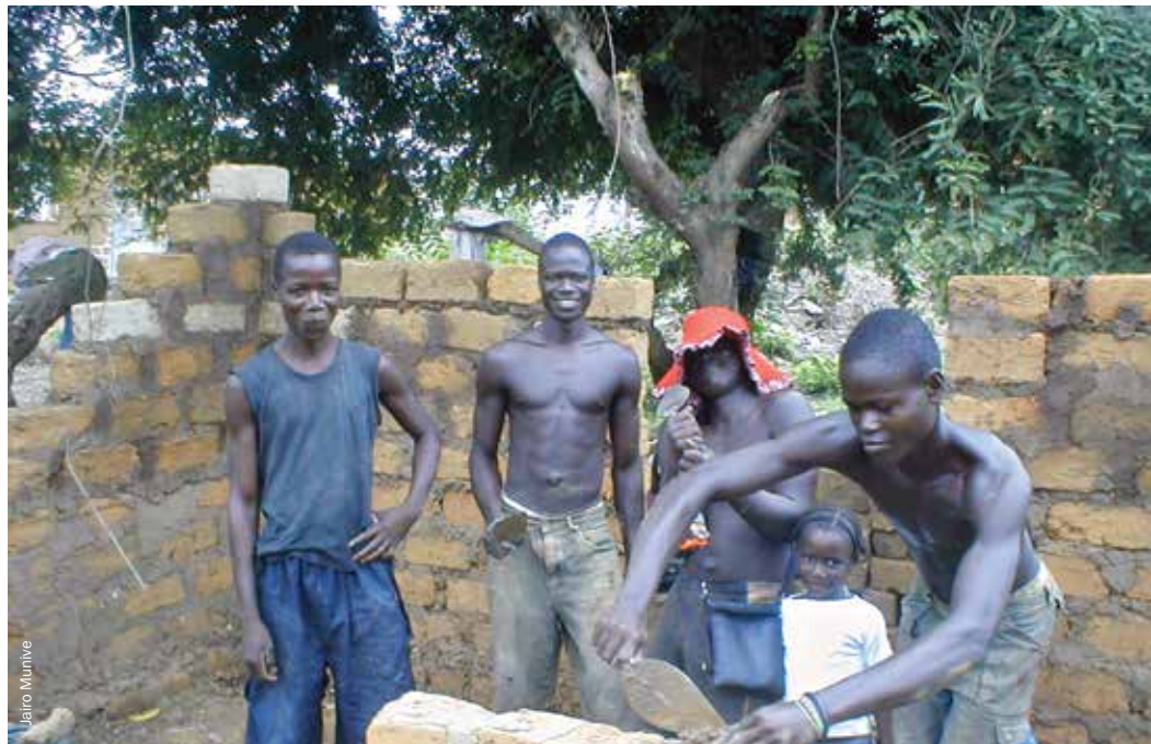
Des anciens combattants et leur famille étendue construisent une maison sur des terres squattées du centre de Ganta.
