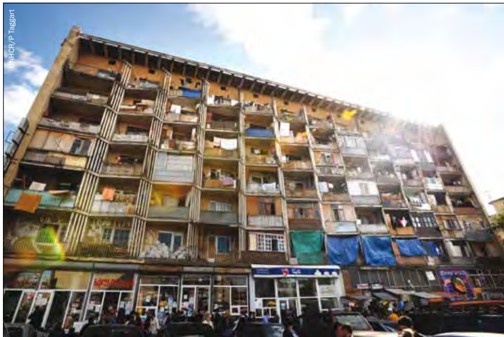
Centre collectif pour PDI dans un ancien hôpital de Tbilissi, en Géorgie. On estime que 148 familles vivent dans ce complexe hospitalier, infesté par les rats et les insectes et dont la structure se délabre.
