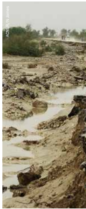
Carretera dañada por las inundaciones en Baluchistán, Pakistán, 2010.
