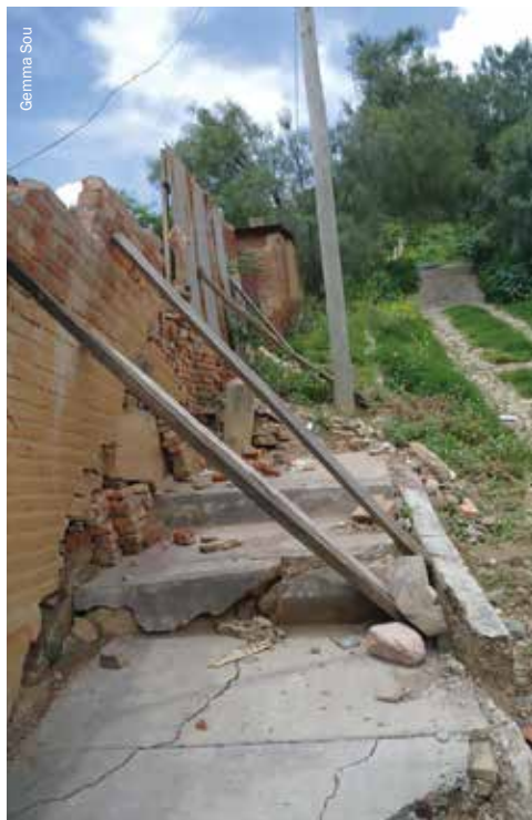
Des planches soutiennent un mur après un glissement de terrain à Cochabamba.
