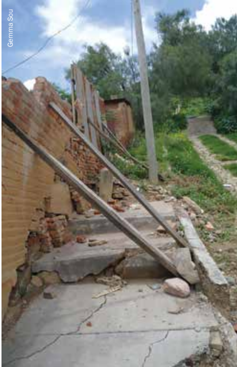
Des planches soutiennent un mur après un glissement de terrain à Cochabamba.
